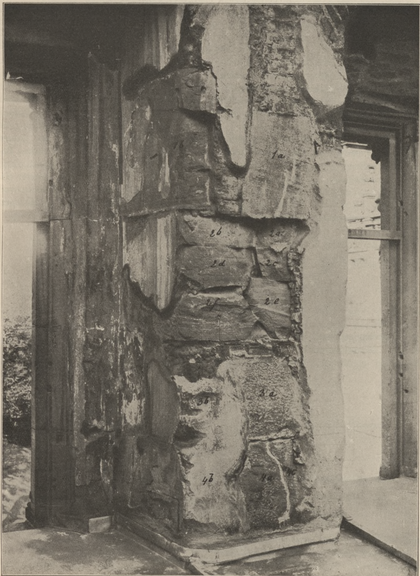
Fig. 26. Stark zerklüfteter Pfeiler im 1. Obergeschoß.
