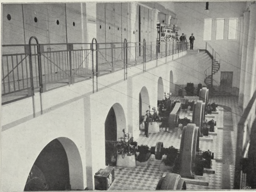
Fig. 92. Finnforsen. Ansicht des Maschinensaales.
