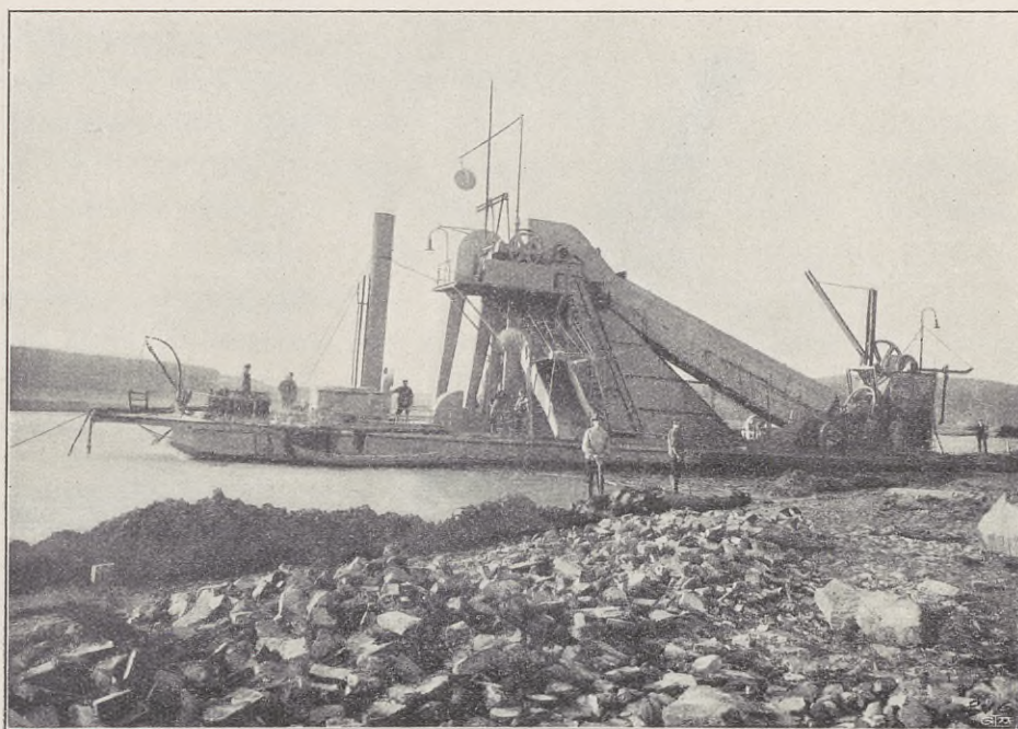
Fig. 24. Mudderverk tillhörigt A.-B. Skånska Cementgjuteriet, användt vid muddringsarbetena mellan Kungälf och Göteborg.
