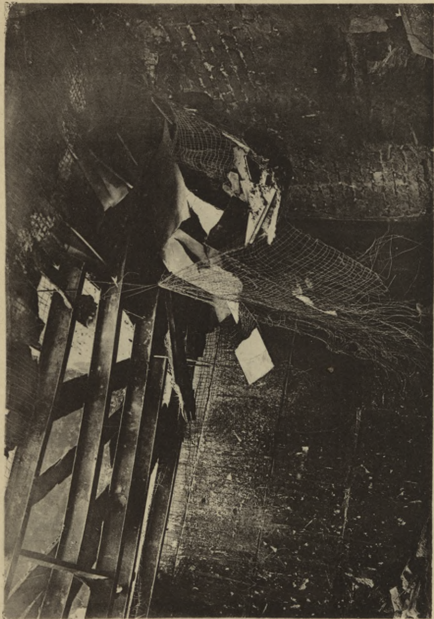
7. Bau-Isothermal-Anstalt, J. F. Hellemann. Decken-Konstruktion. Nach dem Brande.
