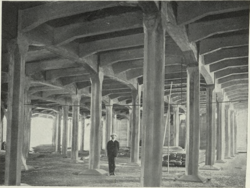
Fig. 28. Ölkeller in Mannheim mit schwer belasteten spiralumschnürten Säulen.
