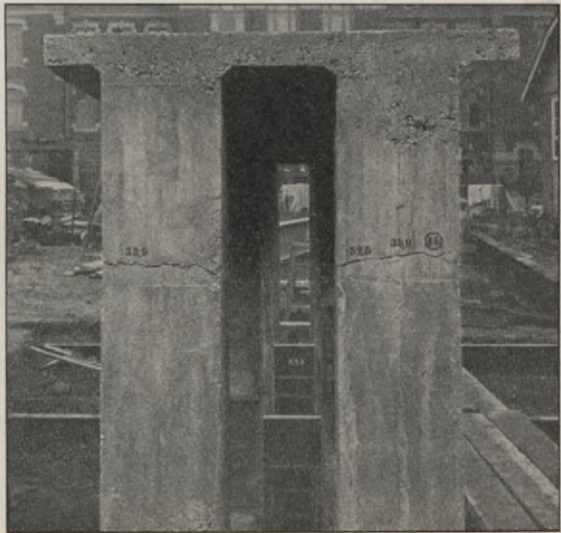
Fig. 12e. Objekt IIIa: Abbildung der in den Stützen auftretenden Risse.
