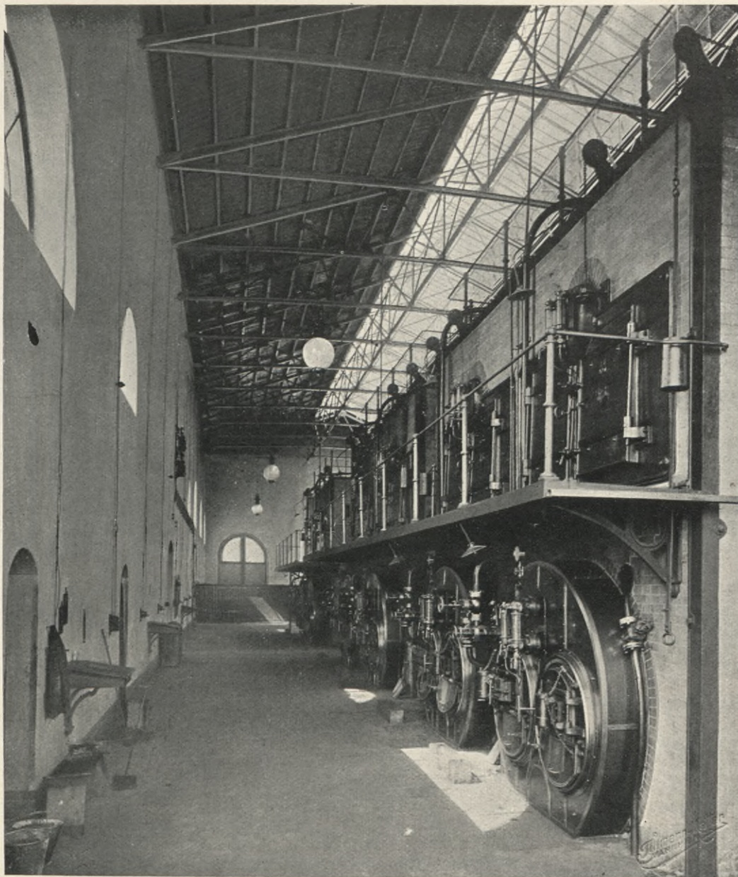
Städtisches Elektrizitätswerk Mannheim, 8 Stück kombinierte Cornwall-Röhrenkessel à 268 qm, 10 Atm.
