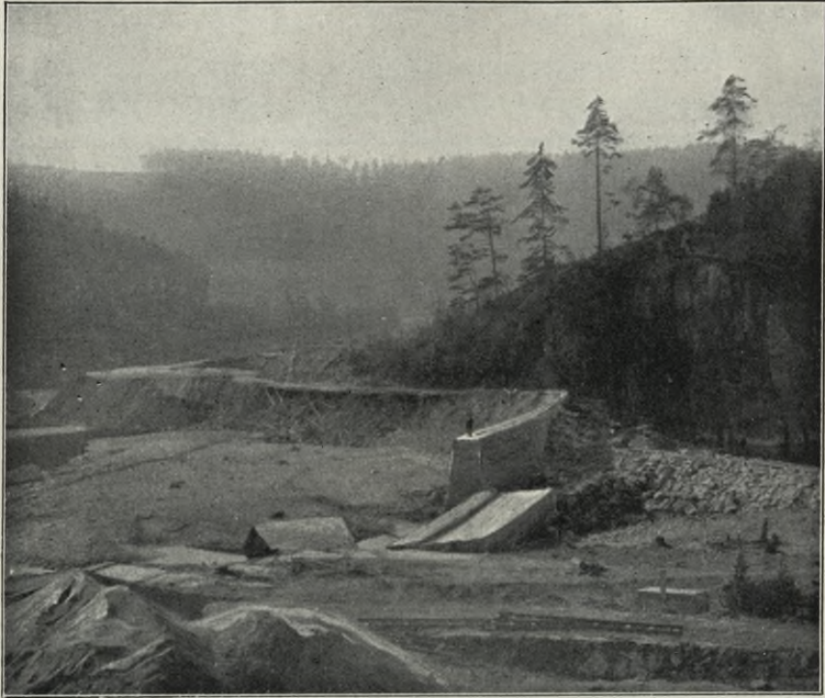
Fig. 9. Das Umleitungwehr. Zerstörung des inneren Betonkernes durch das Hochwasser vom 21. September 1906. Linke Seite.
