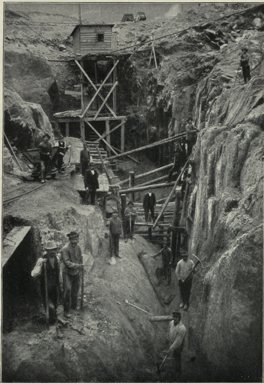
Fig. 12. Die Arbeiten zur Freilegung der Baugrube der Sperrmauer. Der „Riemendorfer Schlitz“ im September 1908.
