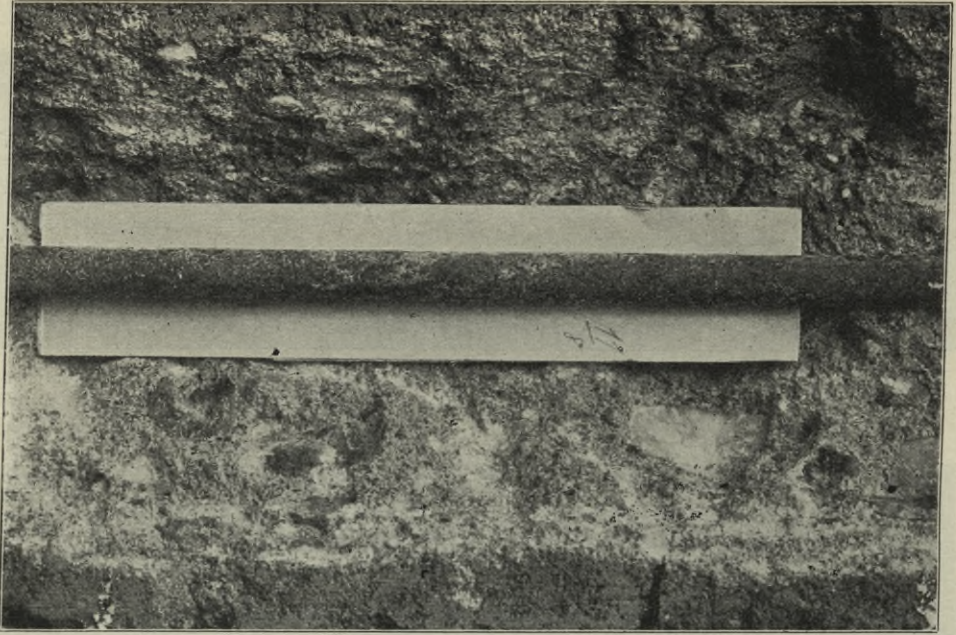
Abb. 235. Freigelegtes Eisen bei Riß 8 der Platte 11. Das Eisen war verrostet eingelegt, neuer Rostansatz ist nicht entstanden.
