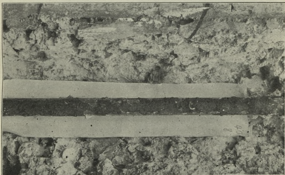
Abb. 258. Freigelegtes äußeres Eisen bei Riß 13 und 14 der Platte 40. Das mit Walzhaut eingebettete Eisen weist Rostansatz der Stärke 5 auf.
