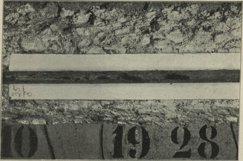
Abb. 255. Freigelegtes Eisen zwischen Riß 10 und 28 der Platte 35. Das blank eingebettete Eisen weist Rostansatz der Stärke 2 auf.
