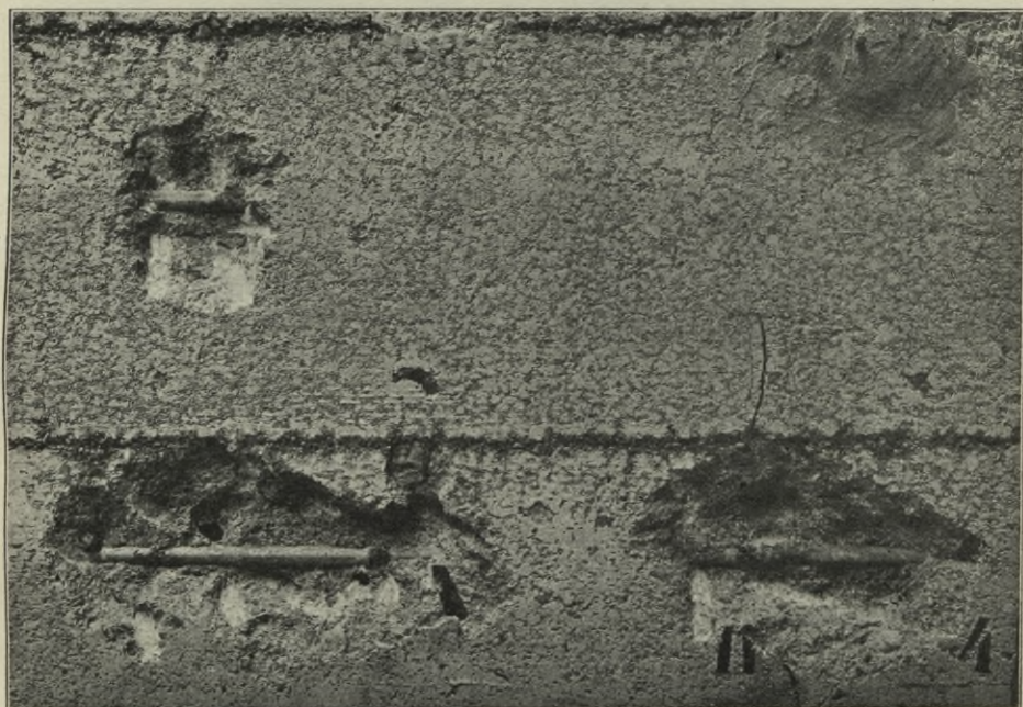
Abb. 160. Rostansatz bei Riß 11 und in der Verlängerung des Risses 5 der Platte 16 (s. Abb. 159 und 149).
