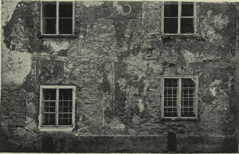
Obr. 278. Prachatice. Knížecí Schwarzenberský dům č. 169 před opravou.
