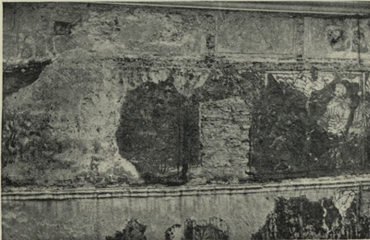
Obr. 279. Prachatice. Knížecí Schwarzenberský dům č. 169 před opravou.
