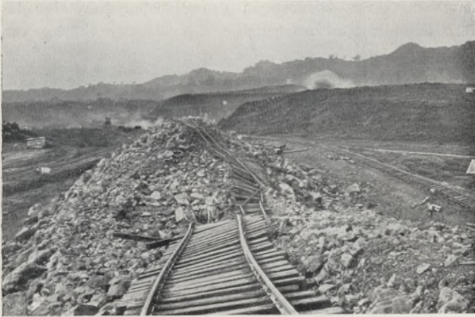
Abb. 24. Sackung am südlichen Böschungsfuße des Gatundammes.
