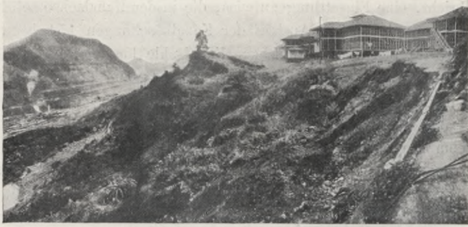
Abb. 10. Rutschung im Einschnitt bei Kulebra.
