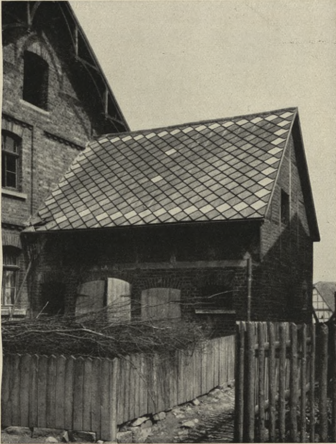
Hässliche und minderwertige Dachdeckung aus gepressten Zementplatten.
