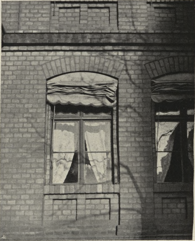
Rohziegelmauerwerk in schlechter Behandlung.
