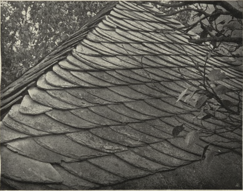
Gut behandelte Schiefer- deckung; am Grat schad- haft (fränkisch).
