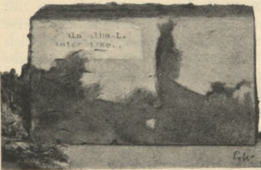
Fig. 1. Birkenholz, von Merulius -Haut teilweise überzogen. Links Haut- und Strangreste vom Kellerfußboden, sich auf die (abgekehrte) Unterseite fortsetzend (Vorderseite des Bildes war Oberseite, hier Messereinstiche und Nageleindrücke).
