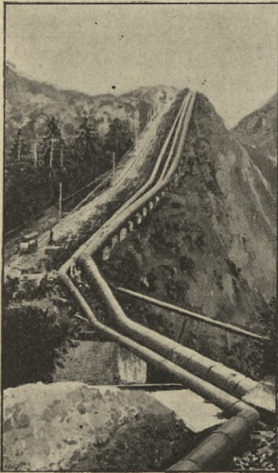
Usine de Calypso, près Saint-Michel-de-Maurienne (Savoie) appartenant à la Société des Produits chimiques d'Alais et de la Camargue
