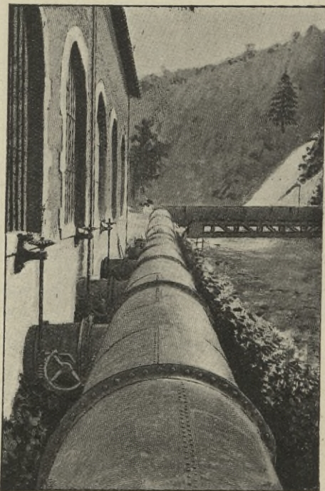
Canalisation distribuant l'eau aux turbines d'une usine de l'Isère. La hauteur de chute est de 45 mètres. Le débit maximum de 8.000 litres ; moyen de 5.000 et en période d'étiage (basses-eaux) de 2.800 litres. Il y a quatre turbines de 550 HP de force chacune. Au total 2.000 chevaux
