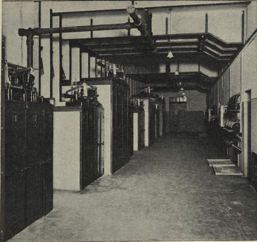
Fig. 20. Högspänningsrum längs transformatorcellerna i kraftstationens ställverkshus (1:a våningen).
