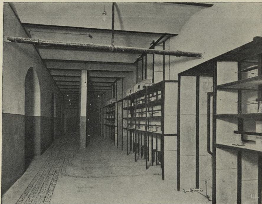
Fig. 19. Inledning i källarvåningen i kraftstationens ställverkshus af 10,000 volts kablar från 1:a utbyggnadens trefasgeneratorer.
