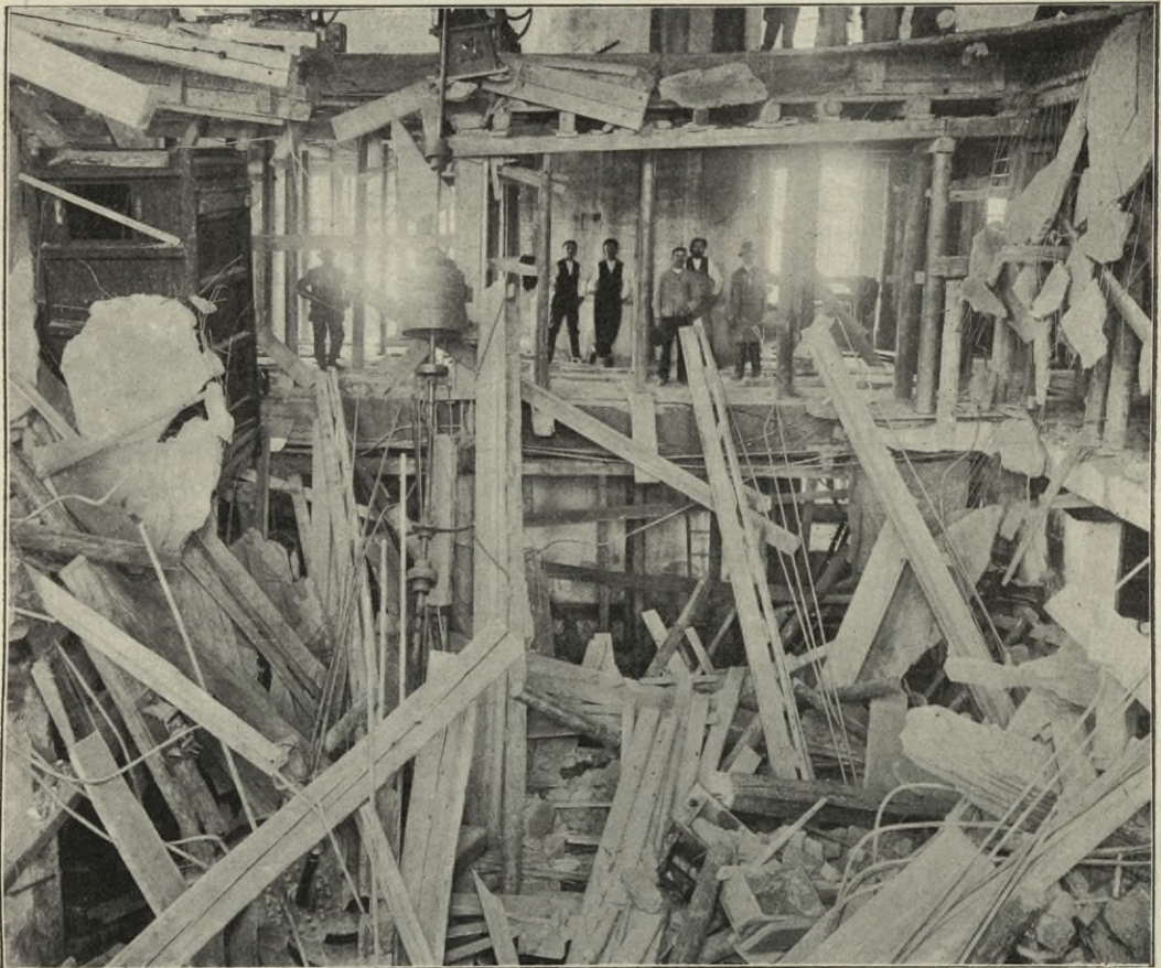
Abb. 53. Einsturz bei voreiliger Montage der Maschinen im Neubau.
