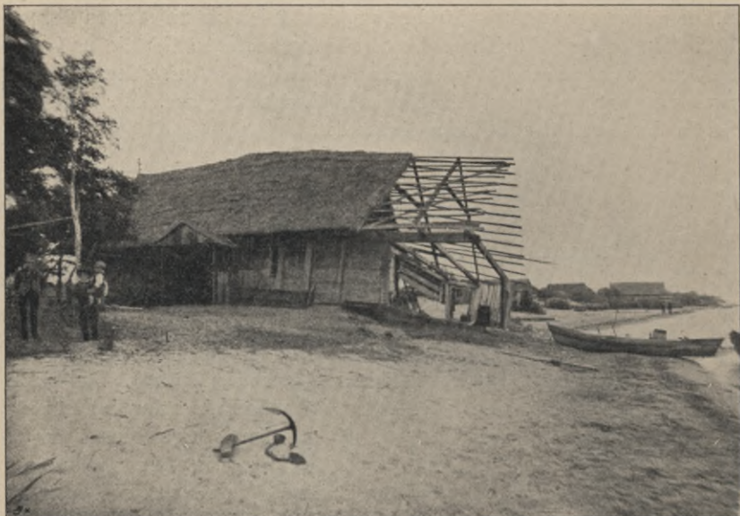
Abb. 438. Vom Haffhochwasser unterspültes Fischerhaus zu Preil auf der kurischen Nehrung.
