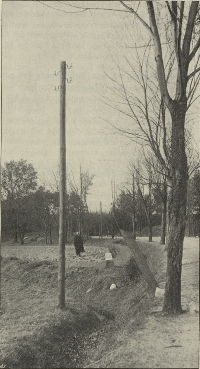
Abb. 60. Freistellen der Telegraphenleitungen durch tiefes Ausschneiden der hindernden Zweige bis an die Hauptäste. Sichtbarmachung der Drahtanker durch Holzbelleidung als Schutz gegen Unfälle.
