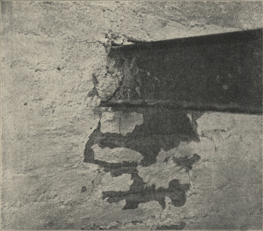
Abb. 302. Rißerscheinungen an den Widerlagern beim Versuch Nr. 3.
