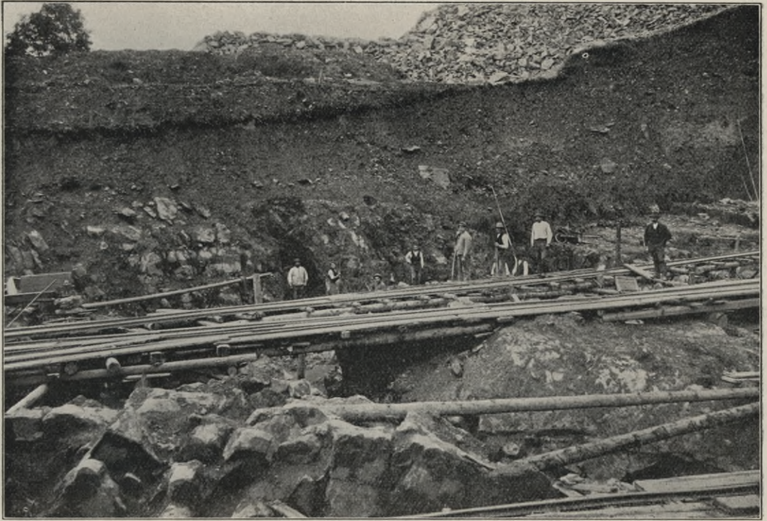
Abb. 64. Klüfte in der Gründungssohle der Mescheder Talsperre.
