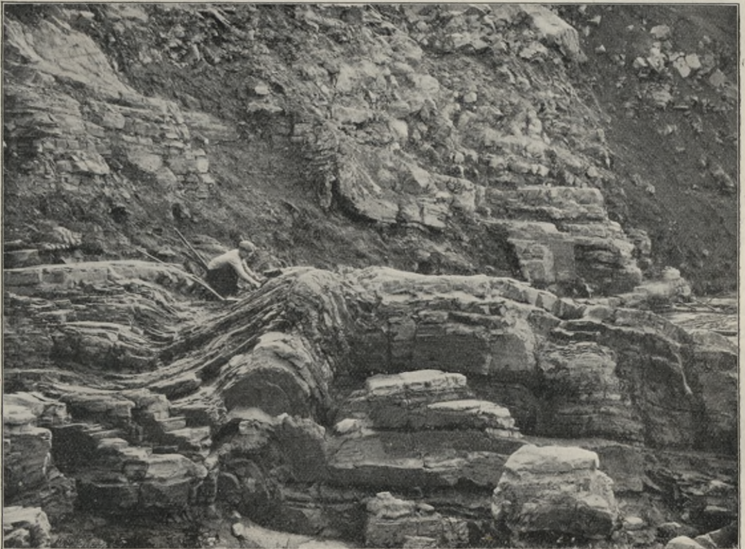
Abb. 65. Verwerfungen der Felsbänke in der Gründungssohle der Mescheder Talsperre.
