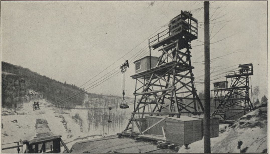
Abb. 305. Zwei radial fahrbare Seilbahnen für den Bau einer Talsperre. Tragkraft jeder Seilbahn 3000 kg. Spannweite 265 m.
