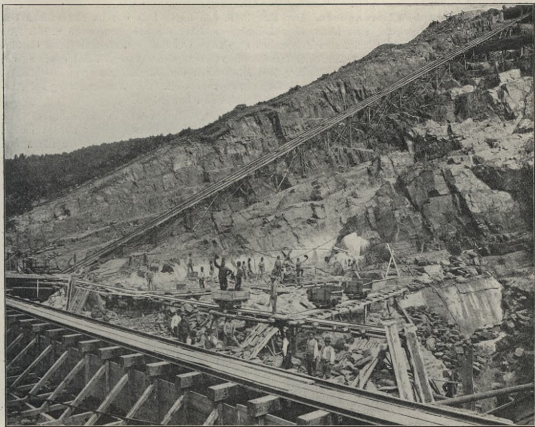
Abb. 295. Verwerfungen am rechten Berghange in der Baugrube der Solinger Talsperre.
