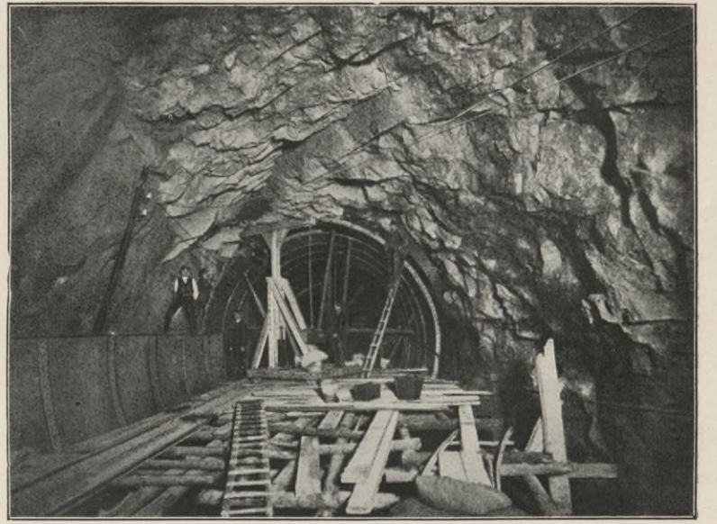
Figur 3. Panzerung eines Umlaufstollens.
