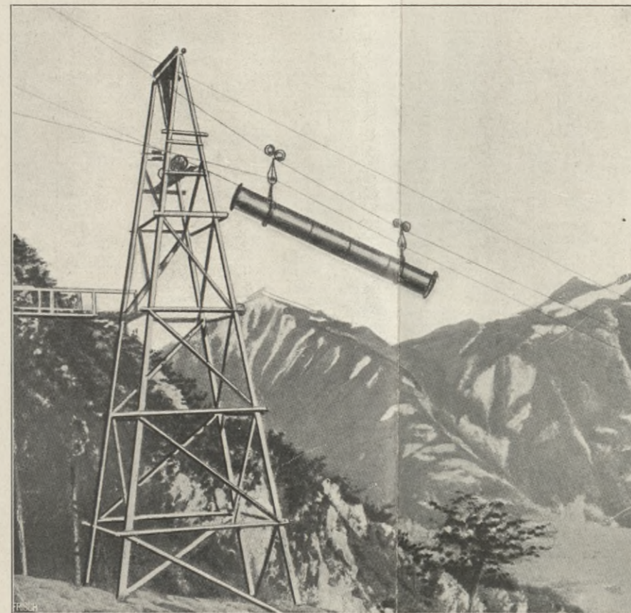
Figur 13. Seilbahn zum Transport von Druckrohren bei Anlage Vouvry (Lac Tanay).
