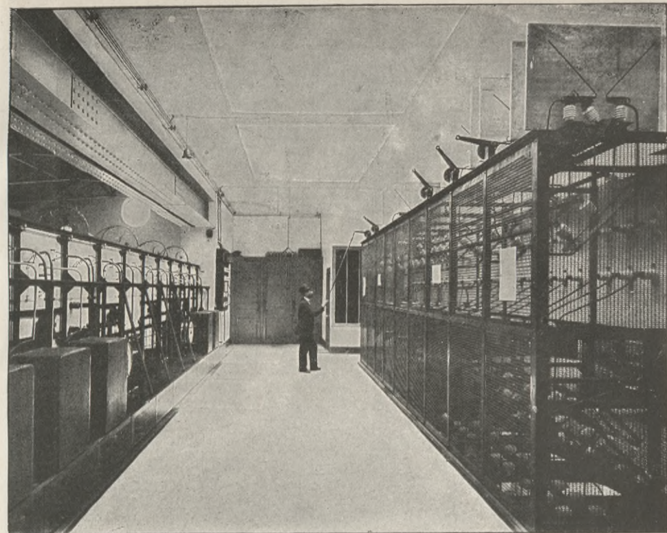
Figur 1. Blick in den Schalt- raum des Kraft- hauses der An- lage Champ (Fure et Morge). Dreh- stromanlage mit 3000 Volt Maschi- nenspannung und 15 000 u. 26 000 Volt Fernlei- tungsspannung. Vergl. Kap. II, 26 und Tafel XLIII. Geliefert von der A.-G. Brown, Bo- veri & Co., Baden (Schweiz).
