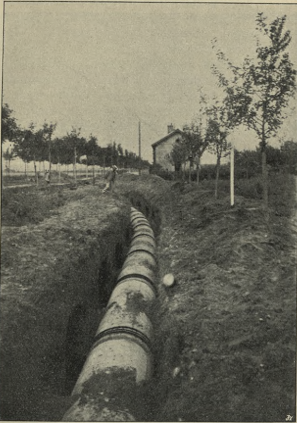
Fig. 208. Druckrohr aus Eisenbeton (System Bonna) während der Anbringung der Überschubmuffen. Rieselfeld von Paris-Achères.
