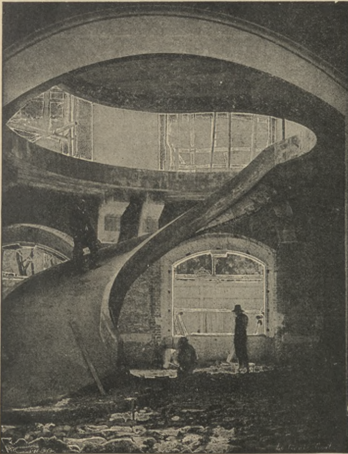
Fig. 9. — Grosse Wendeltreppe im «Petit Palais» in Paris — Ansicht aufgenommen vor der Stufenverlegung.
