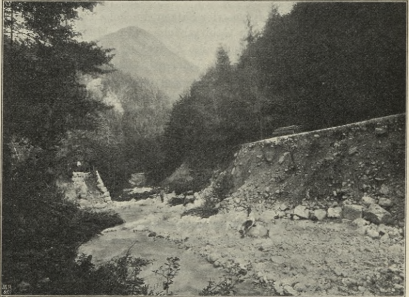
Abbildung Nr. 24. Sohlenvertiefung im Langbathbache, Ober-Oesterreich.
