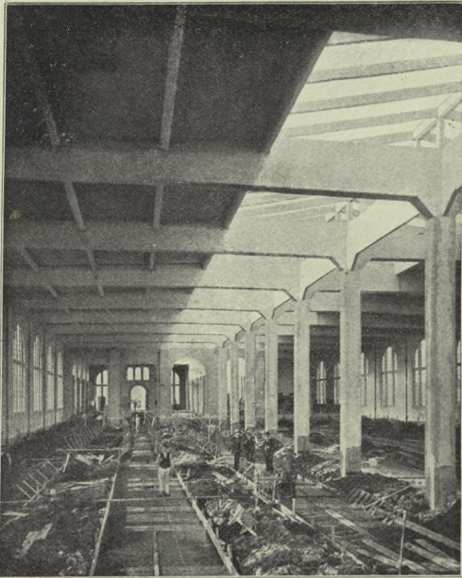
Abb. 53. Innenansicht der Remise in Gravenhage (Aus: v. Emperger, Handbuch für Eisenbetonbau, Bd. IV, Abschnitt: Prof. R. Saliger, Dachbauten, Verlag Wilhelm Ernst & Sohn, Berlin)
