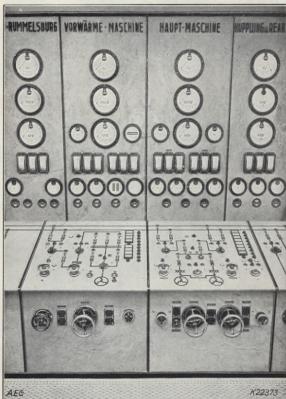
Ein Querschnitt aus den Generatorenfeldern des Großkraftwerks Klingenberg (Taf. XII rechts): an der hinteren senkrechten Tafel die Meßinstrumente, davor die Schaltpulte mit Schaltbildern, Hebeln, Druckknöpfen u. Handrädern zur Fernsteuerung der 44 000 kW-Turbogeneratoren (6 kV) u. Transformatoren (30 kV) (AEG-Berlin).
