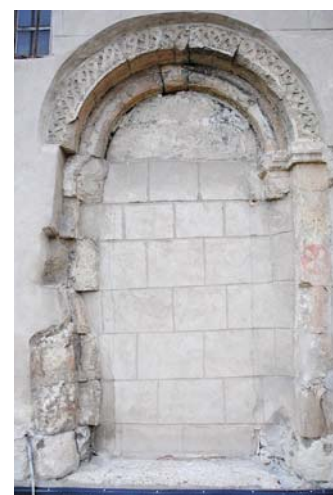
Ryc. 4. Prandocin, kościół parafialny, destrukcja południowego portalu przed konserwacją Fig. 4. Prandocin parish church, remnants of the south portal before conservation
