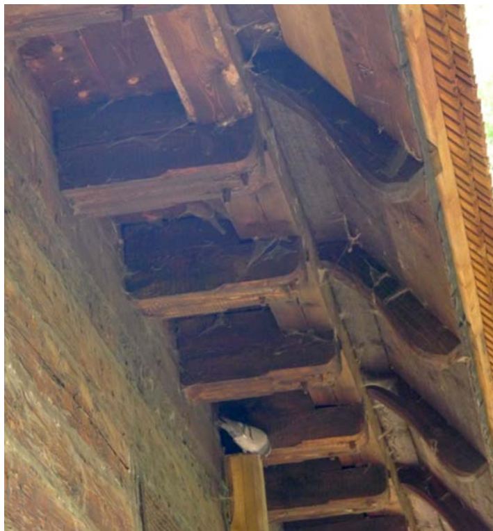
Ryc. 6. Krokwie wystające poza belkę okapową. Belka okapowa dachu oparta na wysuniętych wspornikowo belkach stropowych Fig. 6. Rafters protruding beyond the eaves beam. The eaves beam is supported by protruding structural ceiling joists
