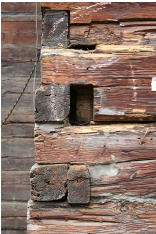
Ryc. 5. Połączenie ścian zrębowych na nakładkę prostą Fig. 5. Lap joints in the wooden log walls
