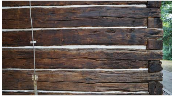
Ryc. 8. Wypełnienie spoin pomiędzy belkami ściany zewnętrznej kitem trwale plastycznym – przed renowacją (zdjęcie górne) oraz fugą mierzalną po remoncie (zdjęcie dolne)
