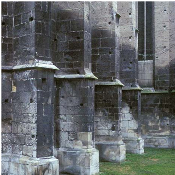
Ryc. 1. Zawilgocenie muru spowodowane podciąganiem kapilarnym wody od gruntu
