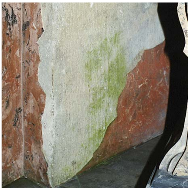
Ryc. 3. Uszkodzenia dekoracji oraz wykwity biologiczne na zawilgoconej ścianie
