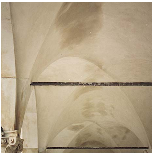
Ryc. 5. Wilgotne plamy na tynku, spowodowane obecnością soli higroskopijnych
