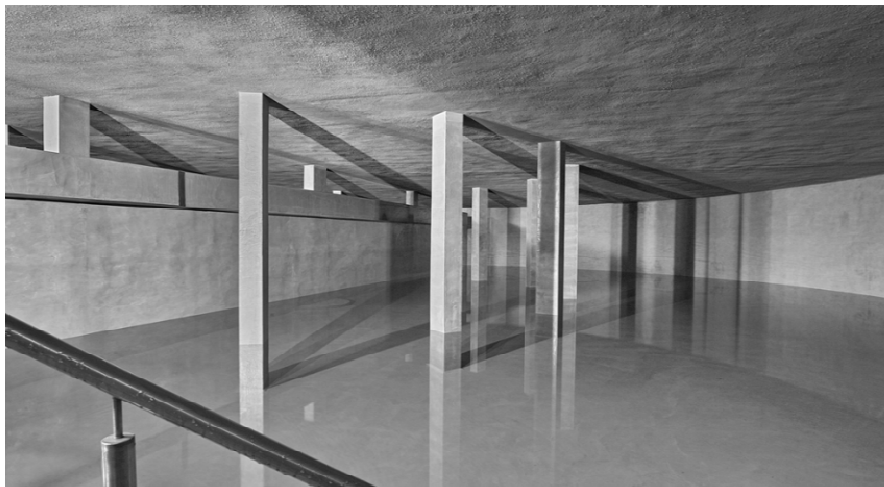
Fot. 2. Stan wewnętrznych powierzchni żelbetowego zbiornika po wykonaniu prac naprawczych w systemie KERASAL® [1]
