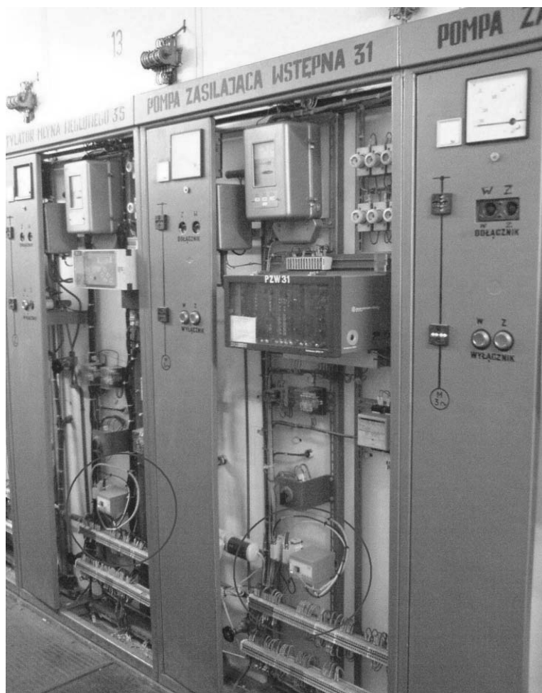
Rys. 6. Instalacja system pomiarowy w elektrowni
