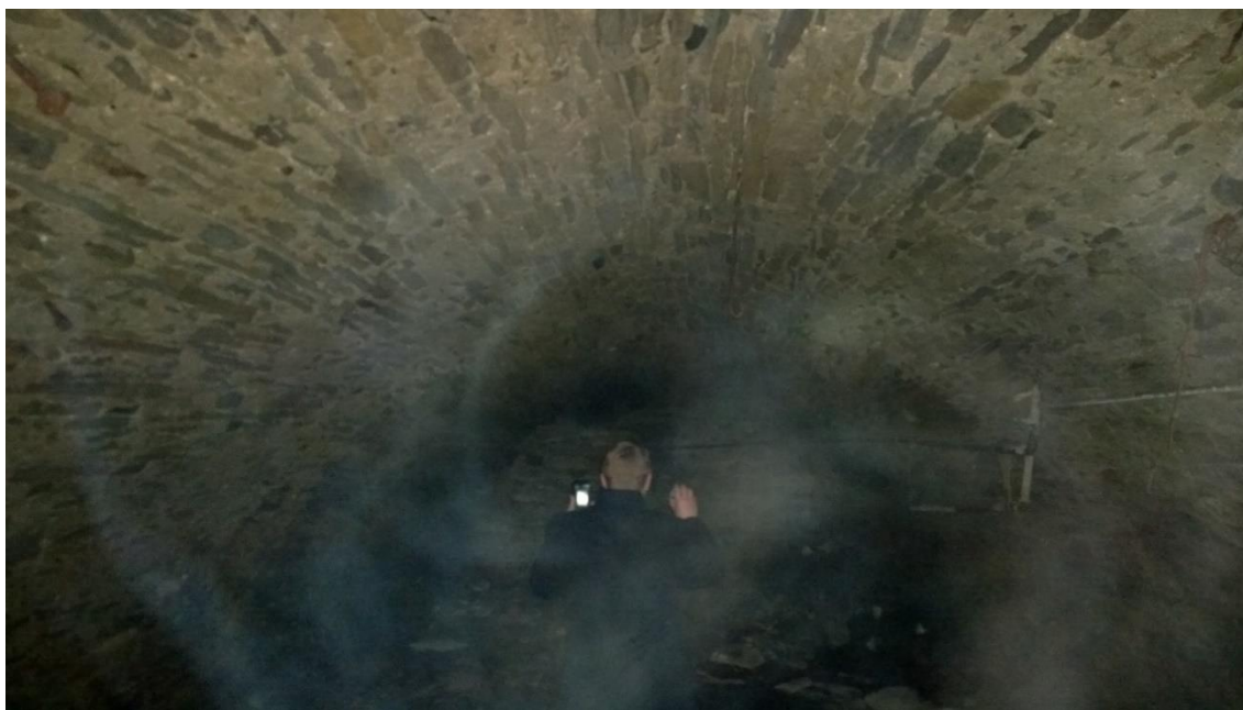
Rysunek 22. Charakterystyczna piwnica kamienna pod jedną z drewnianych chałup południowej pierzei rynku, widoczne zawirowania pary wodnej w pomieszczeniu i zawalona ściana szczytowa od strony rynku. Fot. autor
