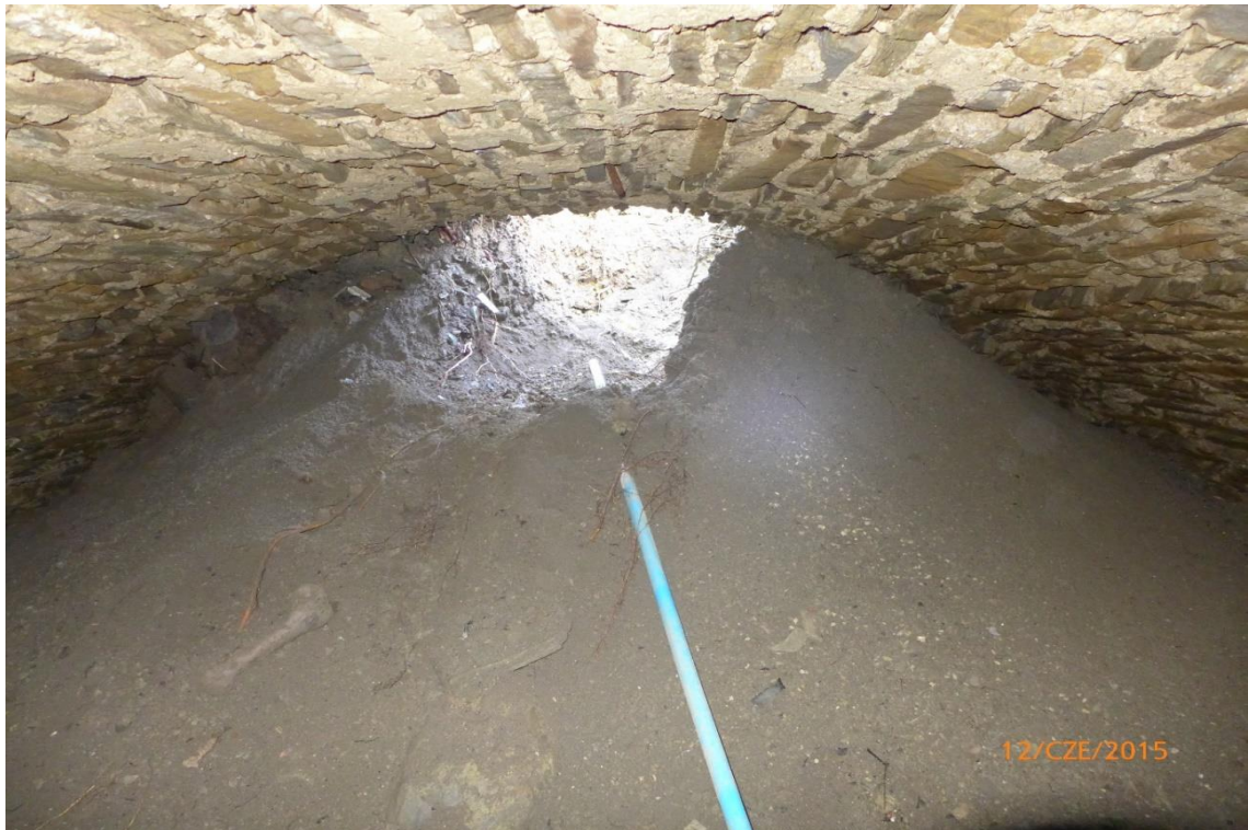
Rysunek 28. Fotografia zniszczonej ściany szczytowej piwnicy w Jaśliskach na działce szkolnej. Komora jest zasypana na dwu odcinkach sklepienia, budowa widocznego przewodu wodociągowego mogła być przyczyną zawalenia się ściany szczytowej. Fot. autor 2015 r.
