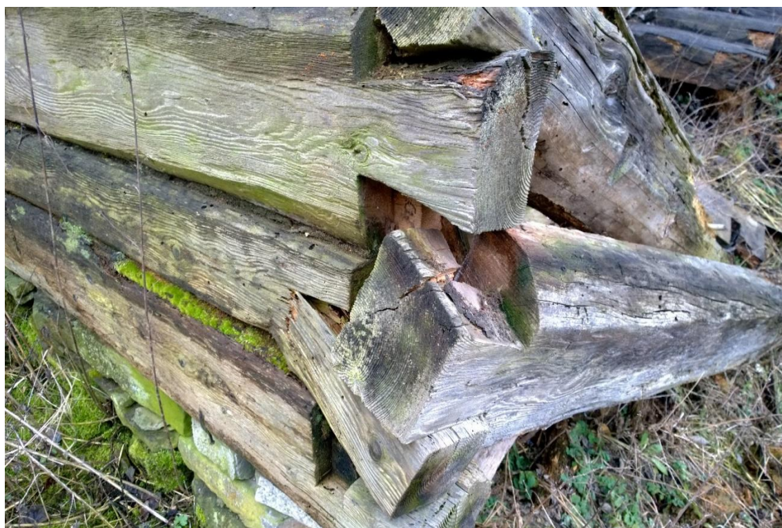
Rysunek 80. Destrukt węgła ściany domu nr 28, widoczny zamek "na rybi ogon" z klinami. Fot. autor 2015 r.
