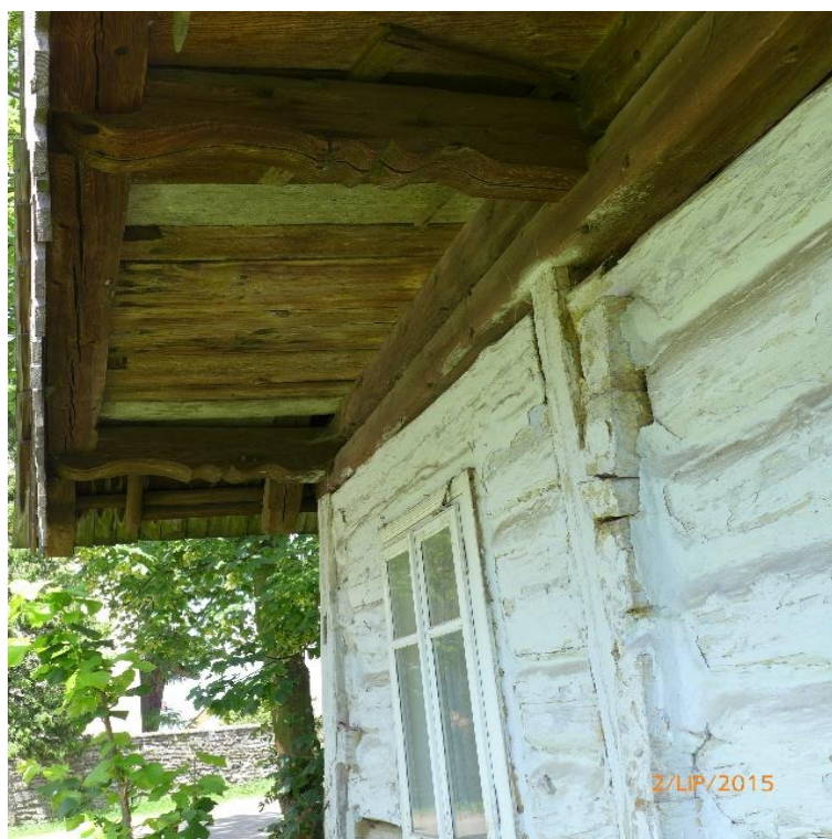
Rysunek 101. Opuszczona chałupa z zagrody nr 126 stanowiąca zlepek elementów starszej i nowszej substancji. Prawdopodobnie do budowy ubogiej XIX wiekowej chałupy użyto starsze i bogatsze elementy konstrukcji przysłupowej i stropowej reprezentowanej przez rzeźbione belki nadwieszzonego podcienia. Fot. autor 2015 r.
