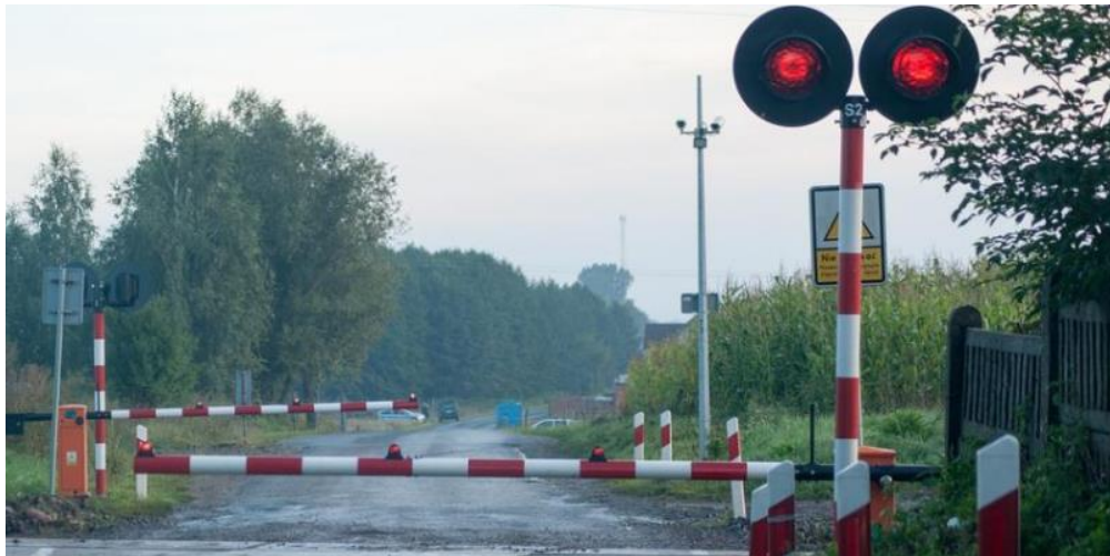
Rysunek 6. Przejazd kat. B zabezpieczony półrogatkami i sygnalizacją Źródło: http://www.przejazdy-kolejowe.kolej.com.pl
