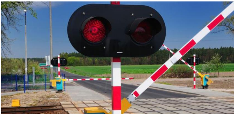
Rysunek 8. Przejazd kat. B zabezpieczony rogatekami i sygnalizacją
