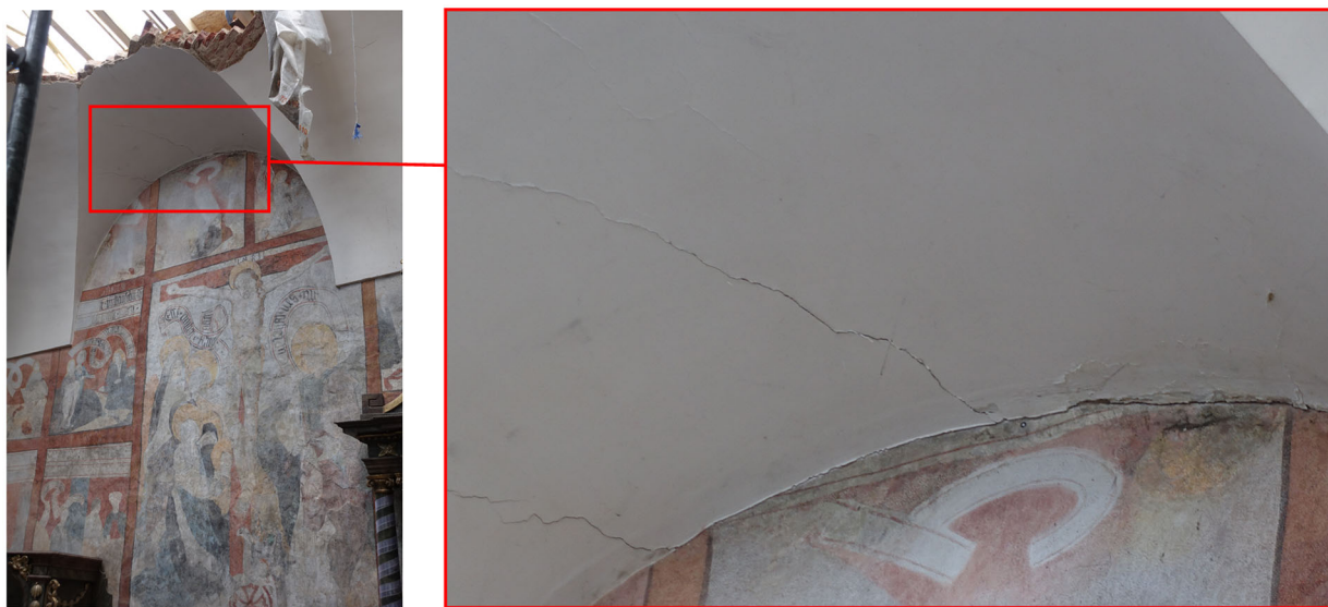
Ryc. 4. Zarysowania na lunecie sklepienia kolebkowego oraz pomiędzy sklepieniem i ścianą z polichromiami (fot. P. Opalka, 6.06.2018) Fig. 4. Scratches on the lunette of the barrel vault and between the vault and the wall with polychromes (photo: P. Opalka, 6.06.2018)
