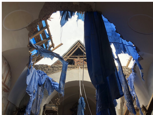
Ryc. 2. Zawalone sklepienie i ściana szczytowa pomiędzy nawą główną i prezbiterium oraz część więźby dachowej. Widok w kierunku prezbiterium (fot. P. Opałka, 5.06.2018)
