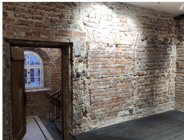
Ryc. 12. Zamek Górny, wieża bramna, poziom I piętra, ściana wewnętrzna z zablokowanym wejściem gotyckim i wylotem przewodu grzewczego, fot. A. Legendziewicz
