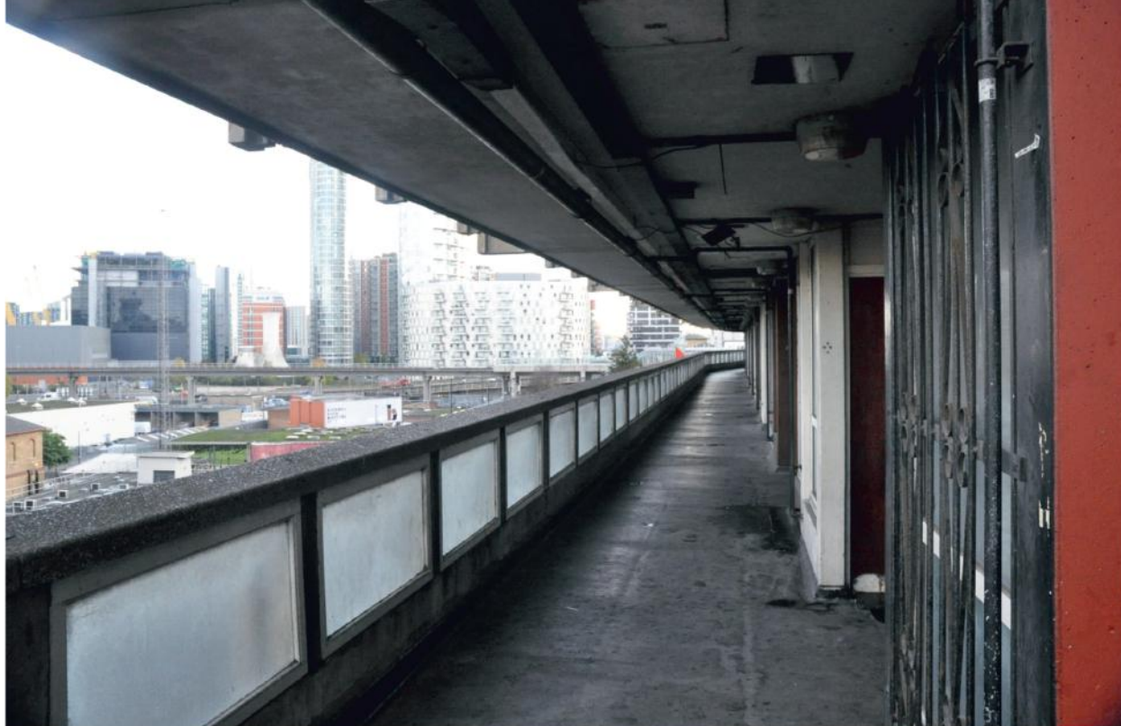
il. 3. Zaniedbana i opustoszała galeria – świadectwo niepowodzenia modernistycznej idei. Fot. P. Pedrycz 2019 ill. 3. The dilapidated and deserted gallery, a testimony to the failure of the Modernist idea. Photo by Paweł Pedrycz 2019
