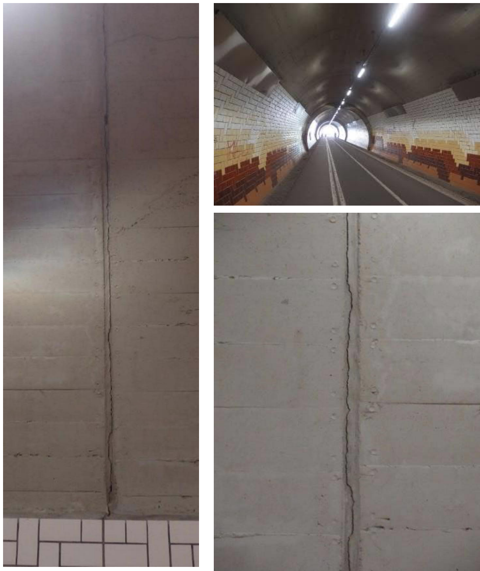
Rys. 2.15 Uszkodzenie połączenia segmentów tunelu (fot. autora)
