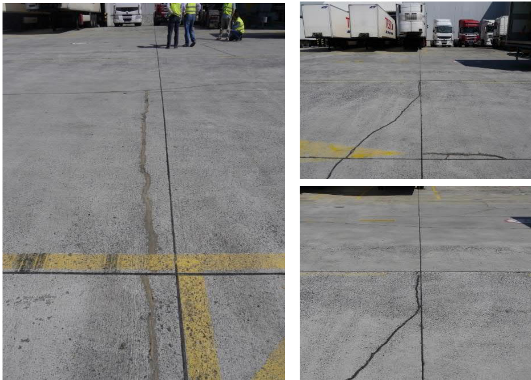
Rys. 2.13 Uszkodzenie nawierzchni betonowej (nieskuteczna dylatacja; fot. autora)
