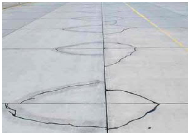
Rys. 2.10 Uszkodzenia narożników nawierzchni betonowej (Kwiecień, 2009b)
