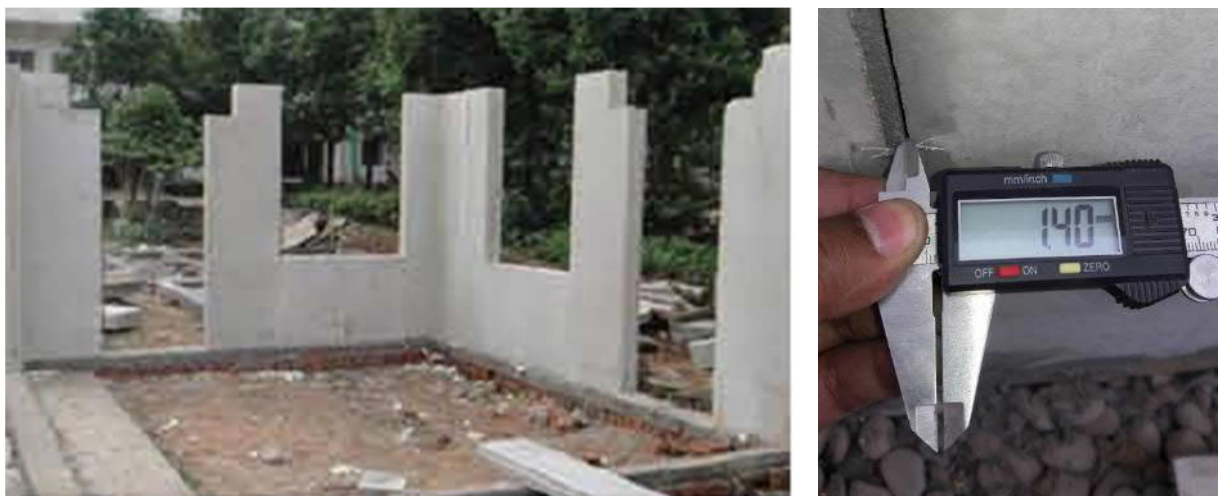
Rys. 2.16 Pęknięcie połączenia ścian prefabrykowanych na skutek doboru nieodpowiedniego materiału łączącego
