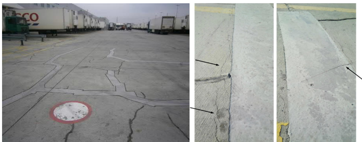
Rys. 2.22 Nieskuteczna naprawa pęknięć nawierzchni betonowej szybkowiążącą zaprawą cementową (strzałkami oznaczono widoczne nowe uszkodzenia)
