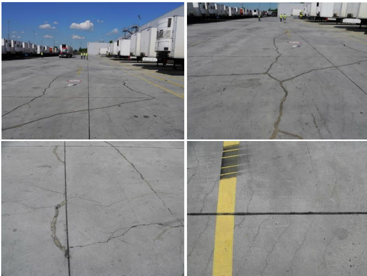
Rys. 2.8 Obraz uszkodzeń nawierzchni betonowej wywołanych odkształceniami wymuszonymi (fot. autora)
