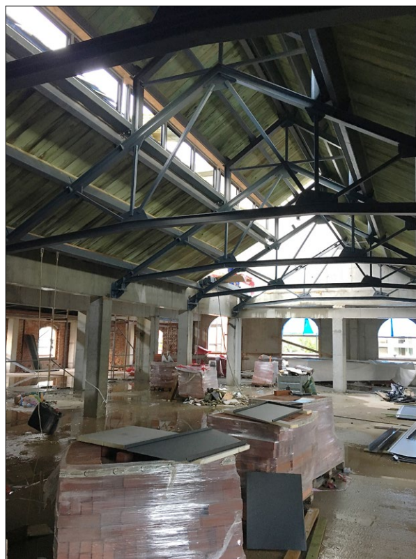
Fig. 8. Second floor interior of the lower part of the plant, visible reconstructed steel structure of the roof; photo by P. Marciniak Ryc. 8. Wnętrze pierwszego piętra niższej części spalarni, widoczna odtworzona konstrukcja stalowa dachu; fot. P. Marciniak.
