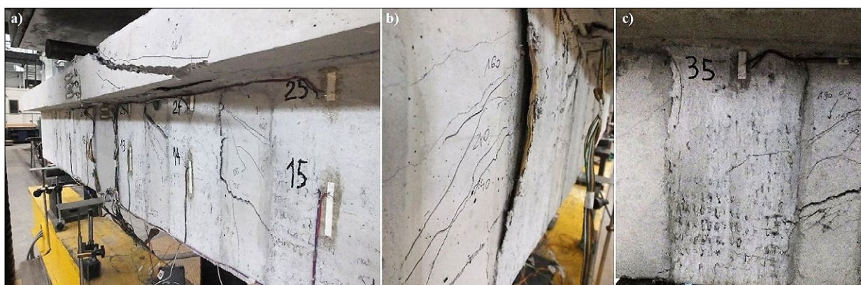
Ryc. 6. Zniszczenie belek wzmocnionych na ścinanie kompozytami PBO-FRCM: a) zarysowanie pod strzemieniem PBO, b) odspojenie strzemienia PBO w warstwie zaprawy, c) widoczne zarysowanie i poślizg włókien na zewnętrznej warstwie zaprawy; fot. autorzy.
