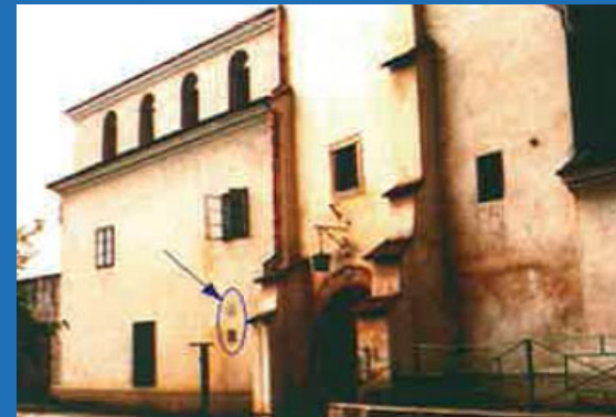
Znaki powodziowe na elewacji klasztoru siostr Norbertanek w Krakowie (UM Kraków)
