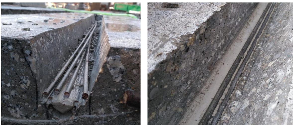
Fot. 45. Otwarty kanał kablowy – niepełna iniekcja i odkryte druty sprężające.
