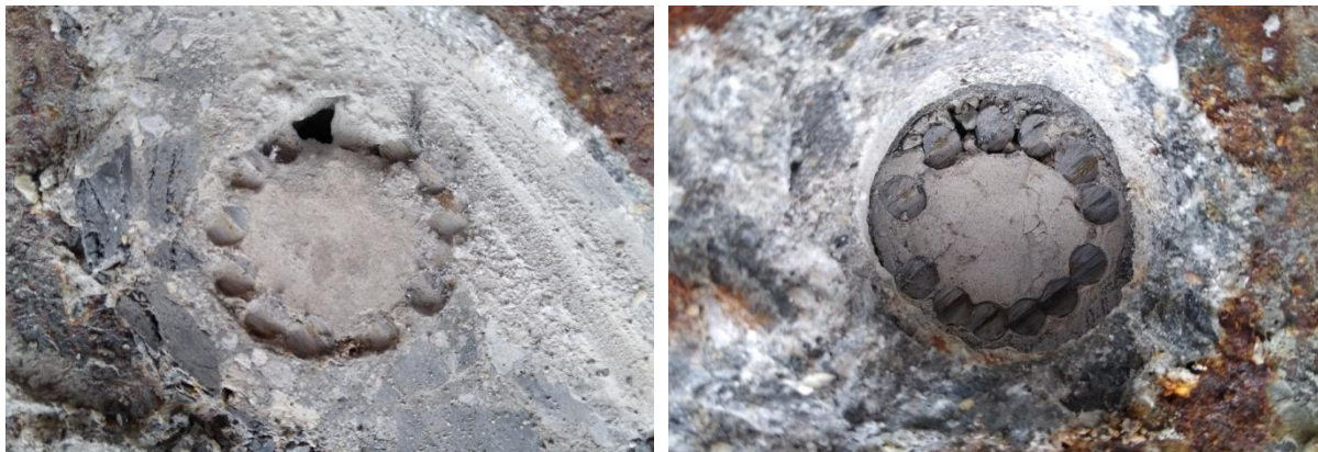
Fot. 50. Widok iniekcji kanałów kablowych w elemencie B 1-2, a) kanał nr 1; b) kanał nr 2.
