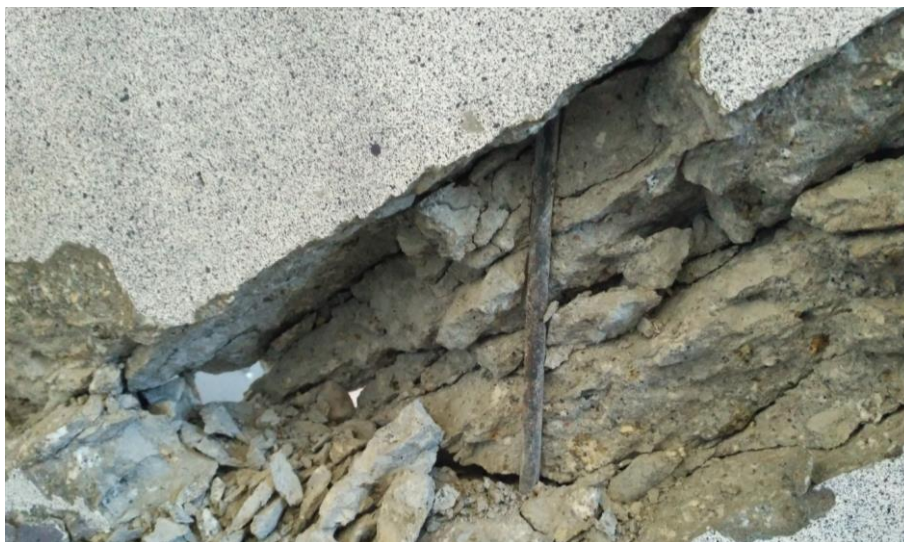
Fot. 23. Widok strzemięcia w rejonie zmiażdżonego krzyżulca.
