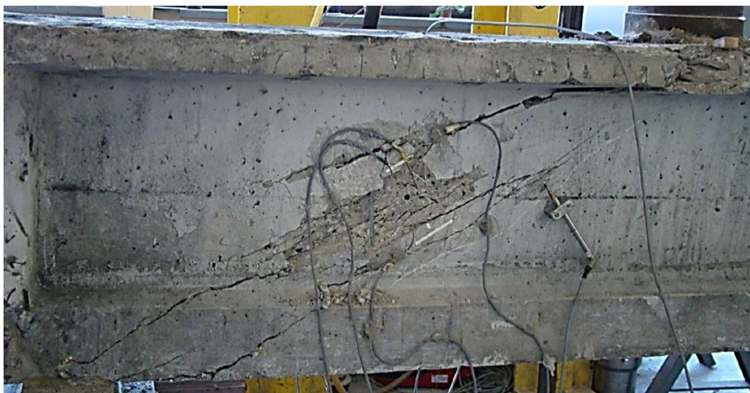
Fot. 6. Zmiążdżenie krzyżulca betonowego [31].
