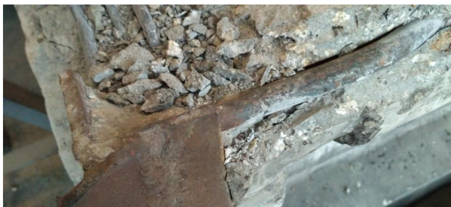
Fot. 11. Pręt zbrojeniowy w półce górnej po wybooczeniu i odłupaniu otuliny.
