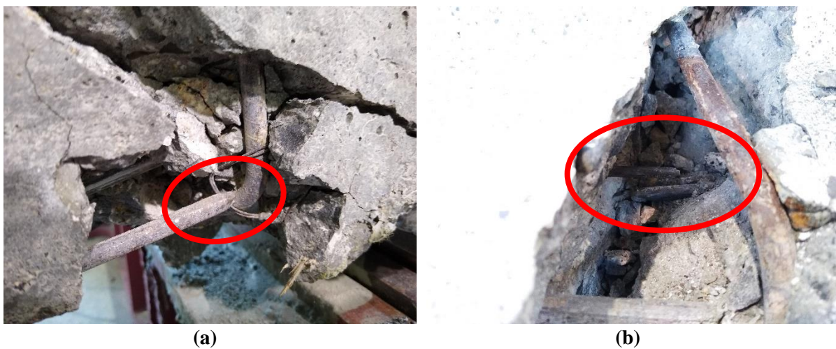
Fot. 29. a) Zerwany dolny pręt zbrojeniowy, b) zerwane druty kabli – badanie B 1-2.
