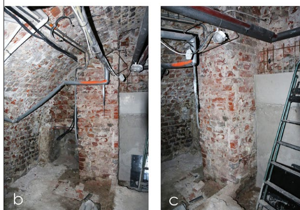
Ryc. 2. Wrocław, ul. Szewska 49; a) przekrój poprzeczny przez obecny gmach z zaznaczeniem pierwotnej wysokości budynku A, przypór i arkad, b) jedna z przypór budynku A odkryta w piwnicach budynku B w widoku czołowym, c) jedna z przypór budynku A odkryta w piwnicach budynku B w widoku bocznym; oprac. rysunkowe i fot. M. Caban i M. Chorowska
