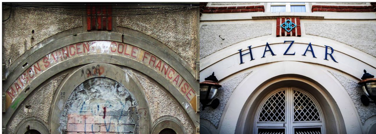
Fig. 10. The sign on top of the entrance – before and after the restoration; photo by H.A. Doğan Ryc. 10. Znak nad wejściem – przed i po rewaloryzacji; fot. H.A. Doğan
