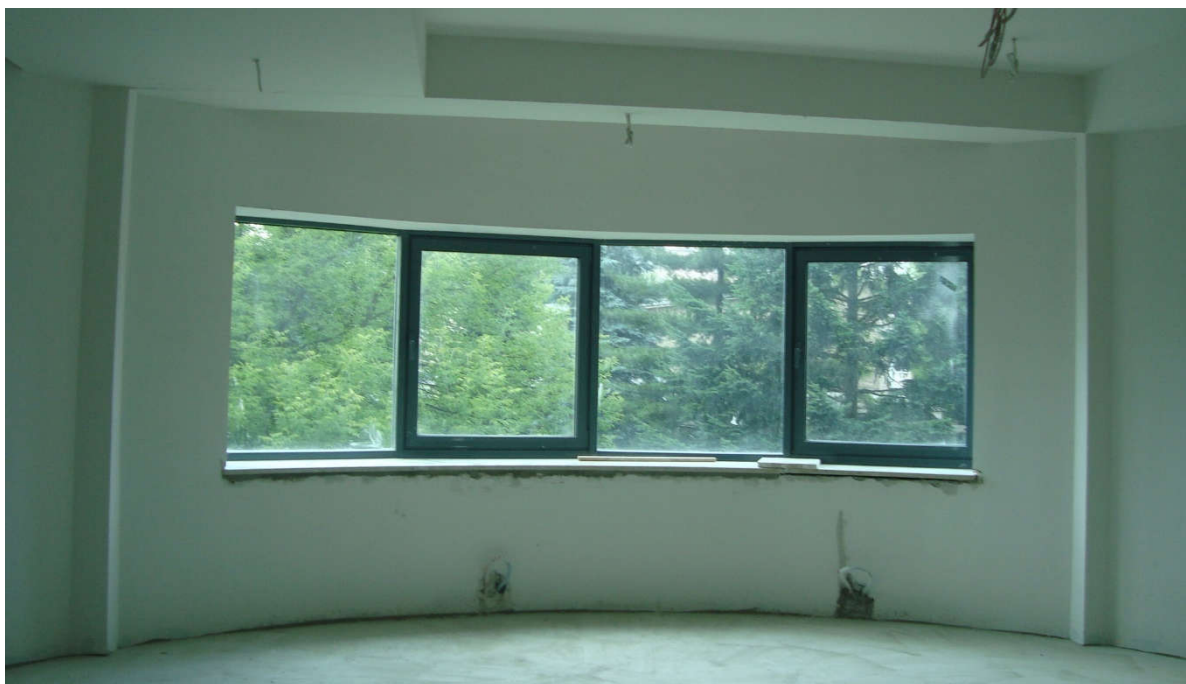
Ilustracja 29. Zespół Państwowych Szkół Muzycznych im. M. Karłowicza, Kraków – sala prób małych zespołów muzycznych – rzut pomieszczenia powstał na planie okręgu. [fot: autorka]
