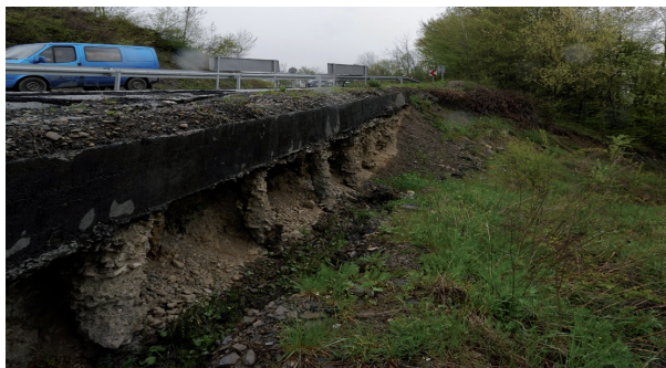
Il. 7. Uszkodzona konstrukcja wzmocnienia w wyniku osuwiska na drodze wojewódzkiej nr 981 w Kąclowej. Fot. E. Pilecka
