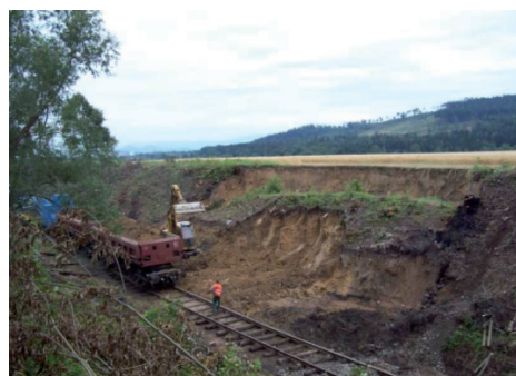
Il. 3. Osuwisko w przekopie linii kolejowej E-283 [14]
