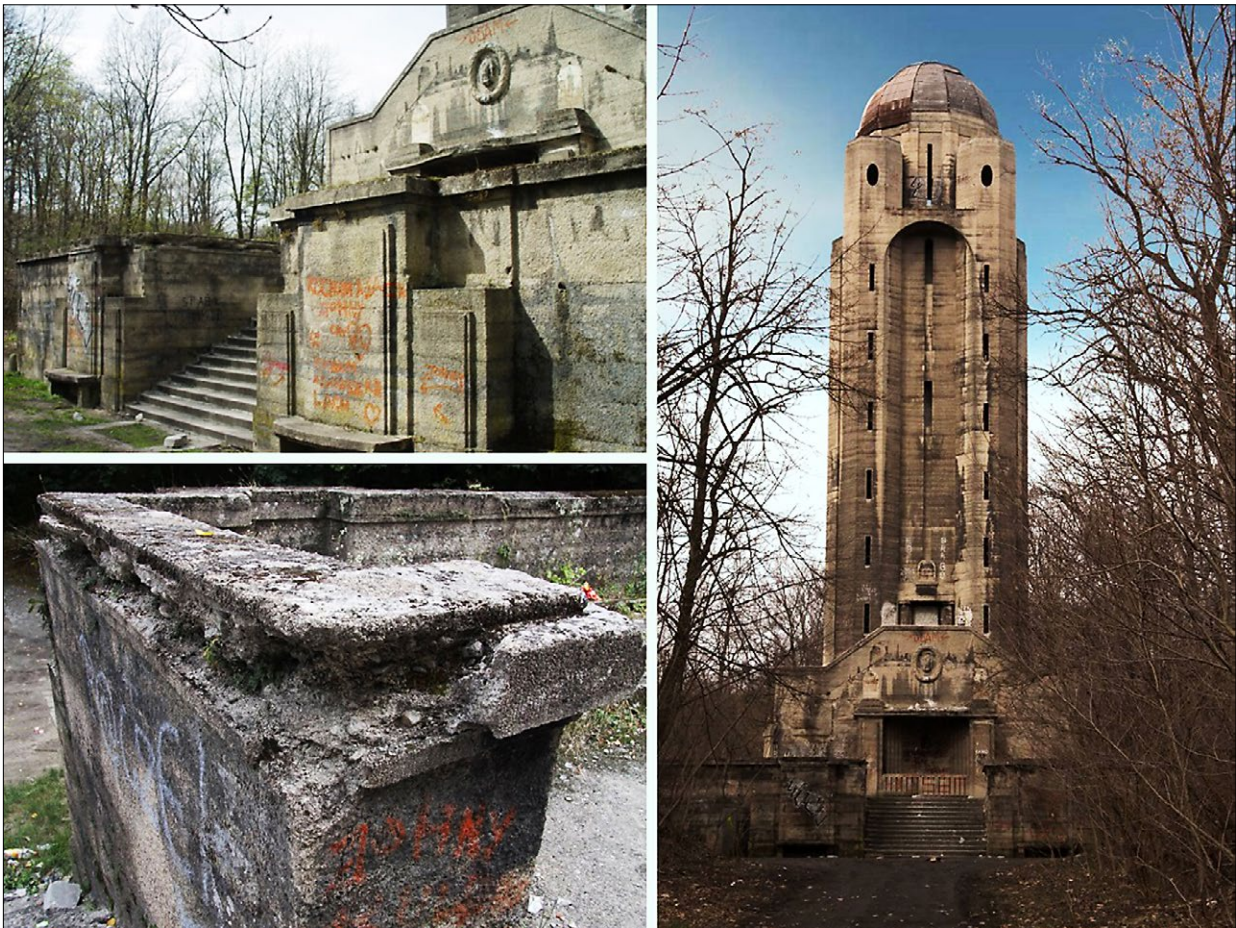
Fig. 3. Water tower in Nysa, pre-adaptation, a) entrance area, b) damaged concrete balustrade, 2007; photos by P. Opalka Ryc. 3. Wieża ciśnien w Nysie, stan przed adaptacją, a) strefa wejściowa, b) uszkodzona betonowa balustrada, 2007; fot. P. Opalka
