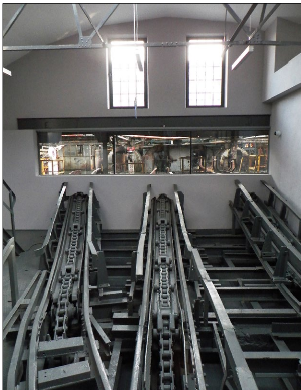
Ryc. 7. Część zakładu przeróbki mechanicznej węgla, przenikanie się struktur zewnętrznych z wnętrzem obiektu; fot. B.M. Walczak
