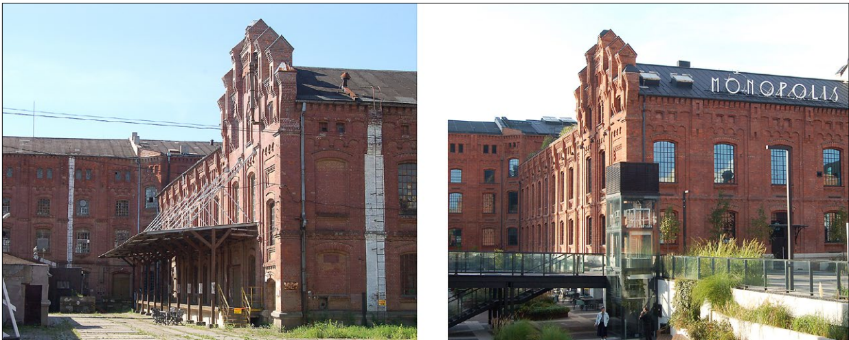
Ryc. 1. Plac wewnętrzny zakładu przed realizacją i po realizacji, widoczna ingerencja w postaci wykopu w celu wprowadzenia dodatkowej kondygnacji; fot. B.M. Walczak
