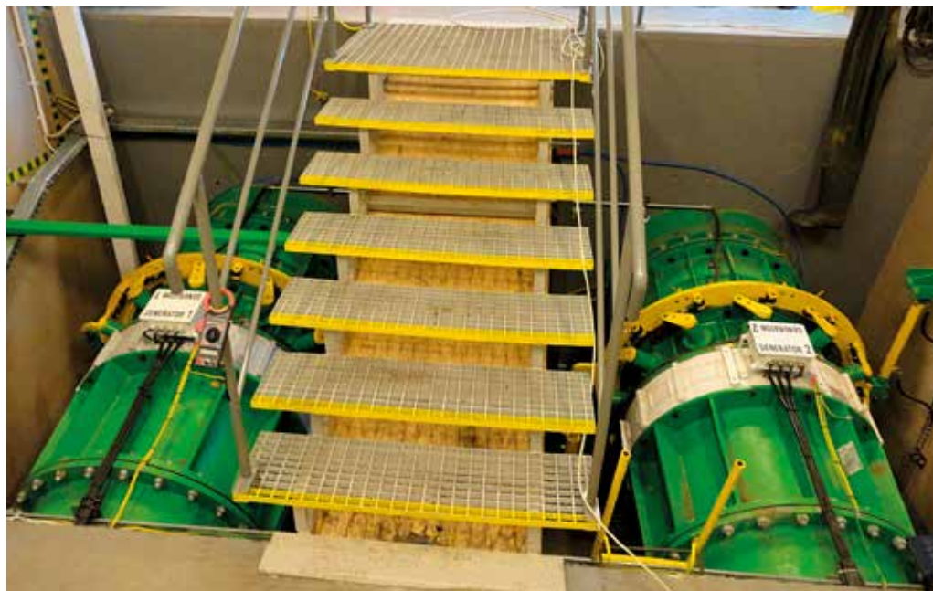
Generatory z magnesami trwałymi zintegrowane z turbinami śmigłowymi.
