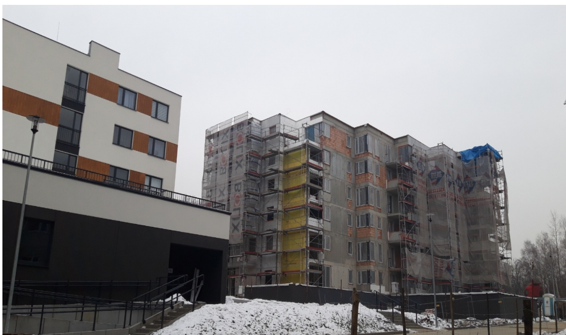
Fot. 5. Widok omawianego przedsięwzięcia w fazie realizacji od strony zachodniej. Stan w rozpatrywanym okresie – drugi miesiąc po reorganizacji (źródło: fot. autorki)
