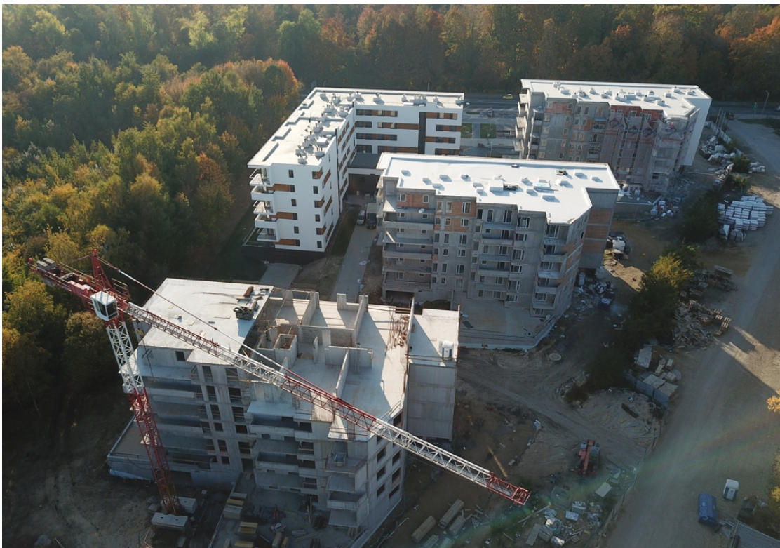
Fot. 3. Widok z drona omawianego przedsięwzięcia w fazie realizacji od strony południowej (źródło: miasto.pro)
