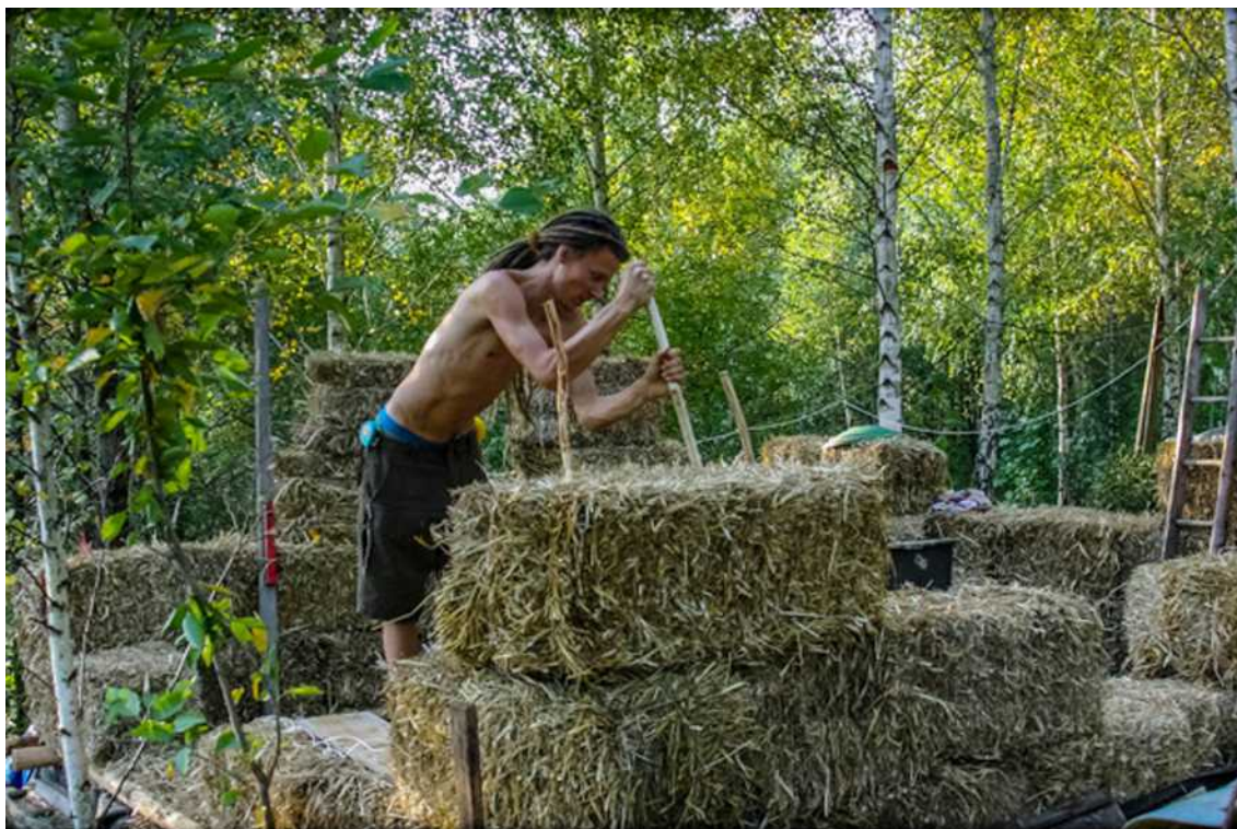
[il. 36] „Leśna chatka” w budowie (2015). Wznoszenie nośnych ścian z kostek słomy. Proj. i wykonanie: Marcin Krzeszewski. Fot. Kalpapada
