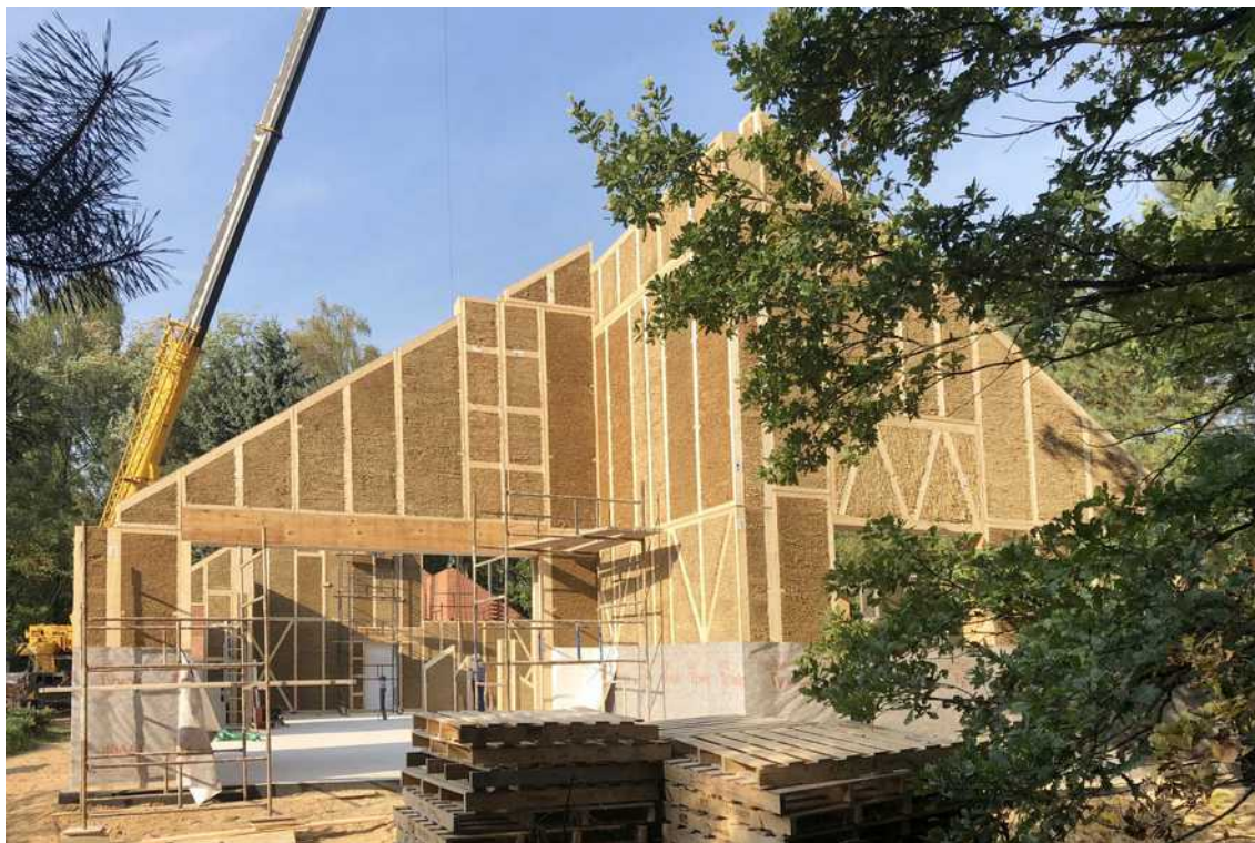
[il. 35] Budowa „ASZ House” w Łodzi z prefabrykatów EcoCocon, 2018–2019. Proj. i fot. Koziej Architekci
