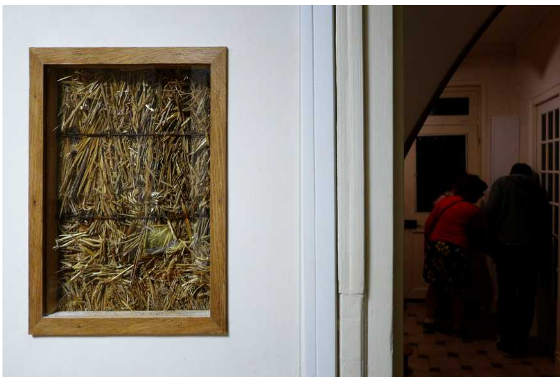
[il. 38] „Okienko prawdy” w domu w Montargis (Francja) umożliwia oglądanie ponad stuletniej kostki słomy w ścianie. Budowa 1920–1921. Proj. Émile Feuillette. Fot. autor
