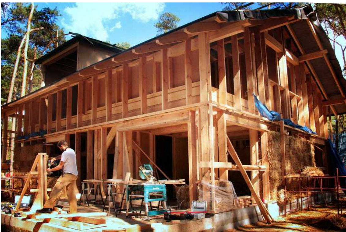
[il. 60] Budowa domu w okolicach Łodzi w roku 2014. Nietypowe rozwiązanie: wewnątrz konstrukcja nośna podobna do tradycyjnej słupowo-ryglowej. Po zewnętrznej stronie lekka konstrukcja służąca do montażu słomy. Proj. NN. Fot. Diggers and Dreamers
