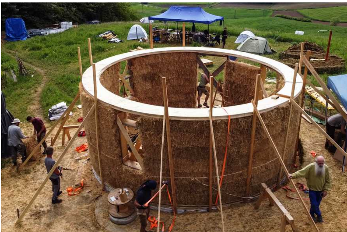
[il. 15] Nośne zastosowanie kostek słomy w ścianach. Budowa niewielkiego domu na planie koła w 2022 roku, Burgerland (Austria). Na górze ściany widać belkę obwodową. Przy ścianach ustawiono tymczasowo słupki wskazujące pion. Pracownicy przygotowują pasy do kompresji ścian. Fot. Mike Deveria
