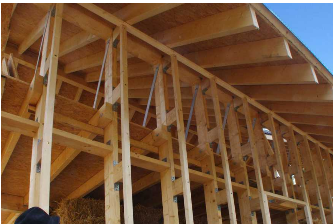
[il. 59] Konstrukcja drewniana z asymetrycznymi słupami dwugałęziowymi. Wewnętrzne słupy obciążone dachem i stropem. Budowa domu w Łodzi w 2013 roku. Proj. Koziej Architekci Michał Koziej. Fot. autor
