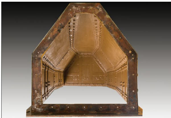
Ryc. 8. Produkty korozji stali i mosiądzu w miejscach styku blach mosiężnych ze stalową konstrukcją; fot. T. Trzos
