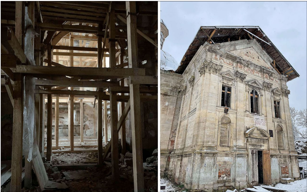
Ryc. 2. Kaplica zamkowa Sieniawskich w Brzeżanach na Ukrainie, stan obecny; z lewej strony wnętrze kaplicy, drewniana konstrukcja podtrzymująca dach, z prawej elewacja zewnętrzna, stan zachowania murów, grudzień 2021; fot. Zespół BIM Monuments
