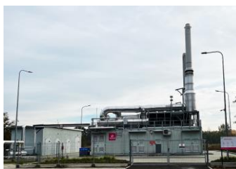
Il. 3.20. Instalacja kogeneracyjna zasilana metanem z KWK Brzeszcze na terenie byłej kopalni Brzeszcze – Jawiszowice (fot. własna, 2022)
